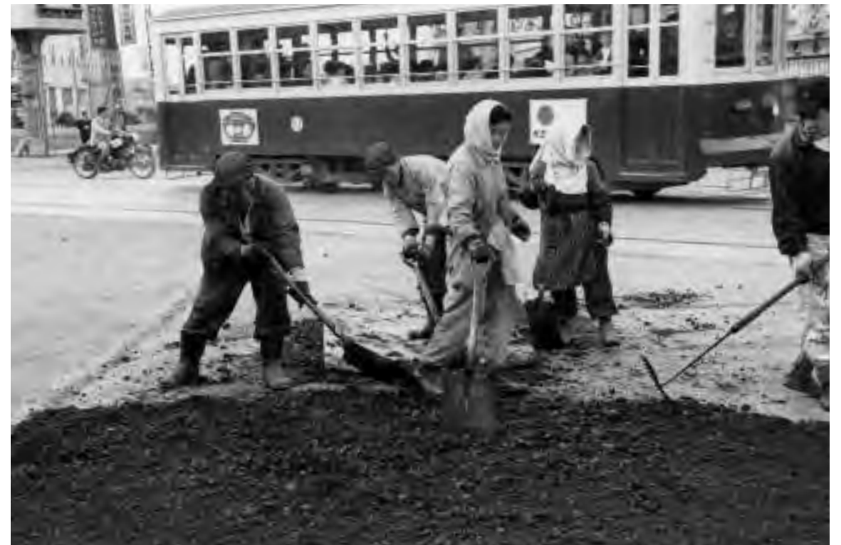
道路の舗装 1955(昭和30)年・福岡市中央区渡辺通 昭和30年代に入り、幹線道路からアスファルト舗装されていった。 左後方に福岡市内線の操車場や電気ビルが見える。
